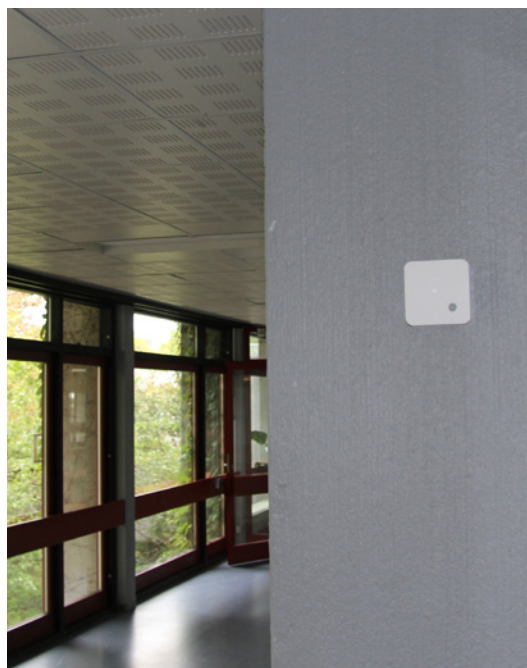
De 50 indeklimasensorer på Sjælsøskolen udveksler data med energiledelsessystemerne. Det gør det muligt at optimere på indeklima og energiforbrug samtidig. Foto: Rudersdal Kommune
