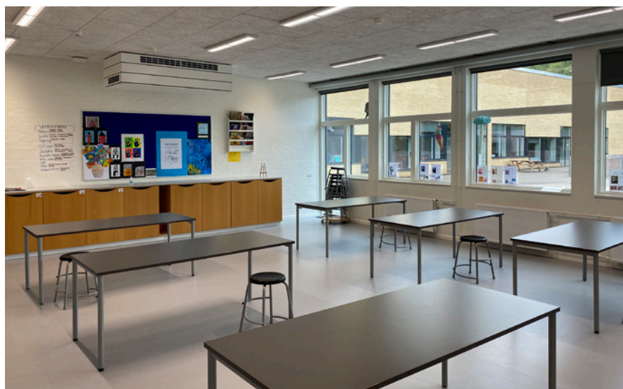
Renoveret faglokale med decentralt ventilationsanlæg, akustikloft, ny gulvbelægning, solgardiner og ny LED-belysning. Foto: Thoms Kjems Lyngvad, Silkeborg Kommune
