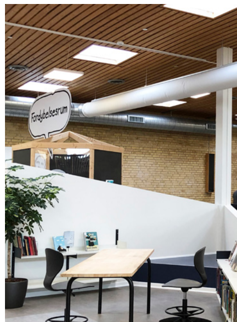
På biblioteket er de nye tekstilkanaler tilkoblet det eksisterende ventilationssystem og ført under loftet. Foto: KE Fibertec
