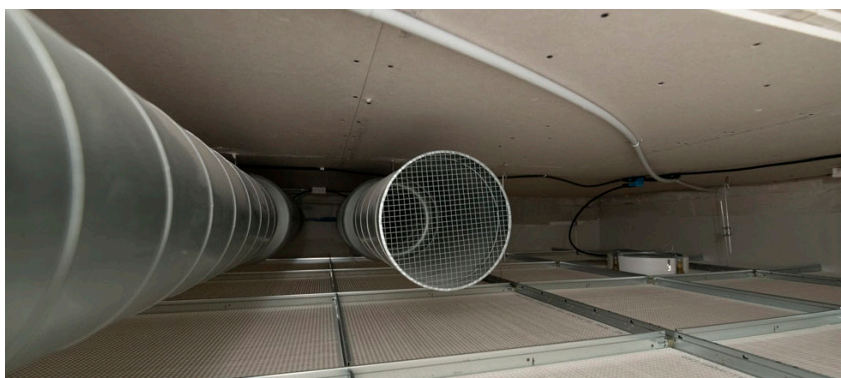
Indblæsningen sker i hulrummet over de perforerede gipsplader, der både slipper den friske luft ind i lokalet og dæmper akustikken. Foto: Knauf
