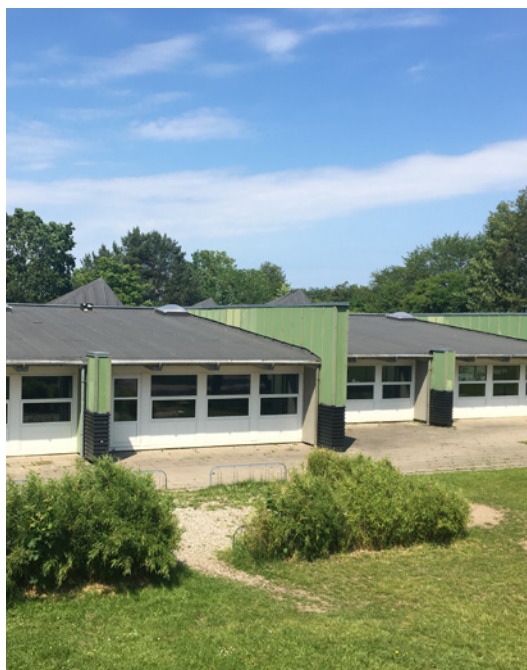
På Nordvestskolen er der efter screening blevet bevilget midler til renovering og forbedret ventilation. Foto: Helsingør Kommune
